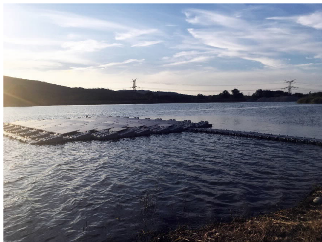
Projet d'aménagement Rhône Energies – Prototype de la centrale photovoltaïque flottante AKUO de Piolenc © Aurav – 2017
